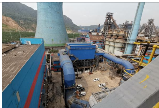
钠基干法脱硫除尘一体化设施
